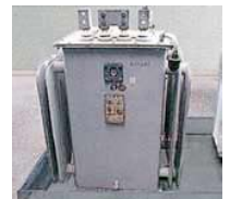
大型変圧器(トランス)
